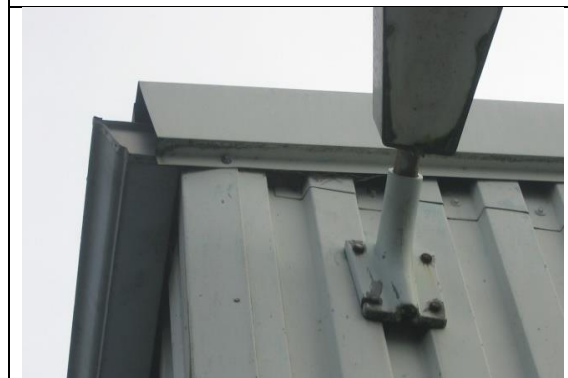
Foto 2: Offene Stelle beim Abdeckblech an den Dachecken
