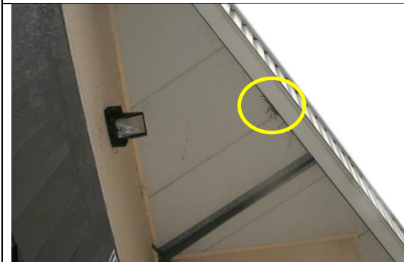
Foto 12: Vogelnest im Vordachbereich der Verladezone
