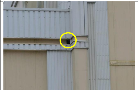
Foto 13: Offener Fassadenbereich im Übergangsbereich
