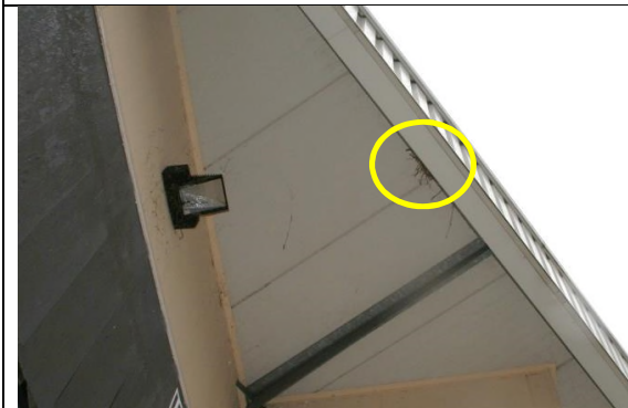
Foto 12: Vogelnest im Vordachbereich der Verladezone
