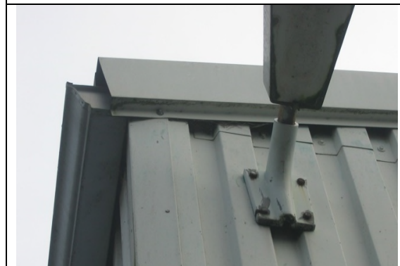
Foto 2: Offene Stelle beim Abdeckblech an den Dachecken
