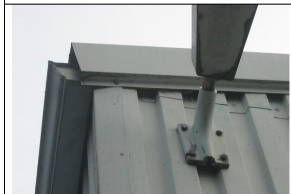
Foto 2: Offene Stelle beim Abdeckblech an den Dachecken
