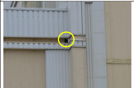
Foto 13: Offener Fassadenbereich im Übergangsbereich
