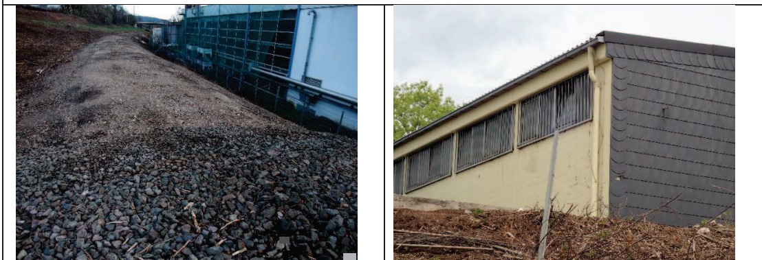
Im nicht von Mauereidechsen besiedelten Abschnitt II (links) wurde mit dem Abtrag des Gleisschotters begonnen (li.) Das ehemalige THW-Gebäude mit seinem Kunstschiefer-Giebel (re.) wurde auf Fledermäuse überprüft.
