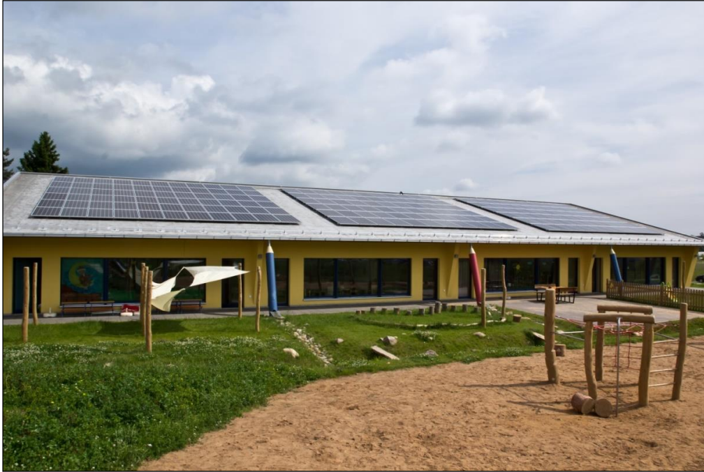
Abb.17: Kita Vitelliuspark mit installierter PV-Anlage
