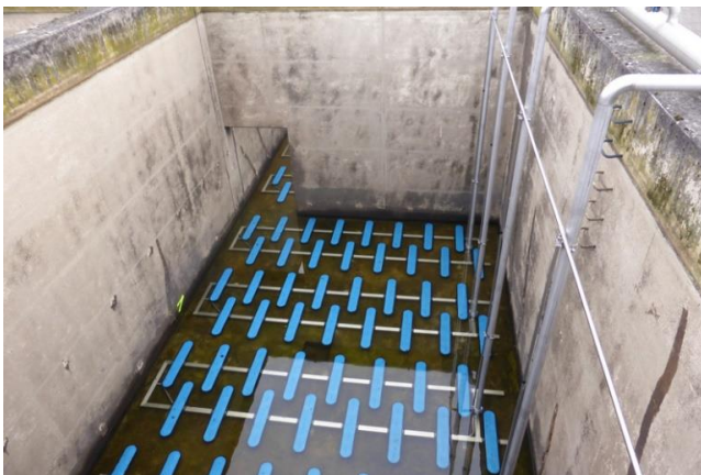
Abb. 15: neuer Plattenbelüfter im Belebungsbecken
