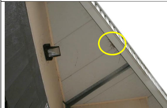
Foto 12: Vogelnest im Vordachbereich der Verladezone
