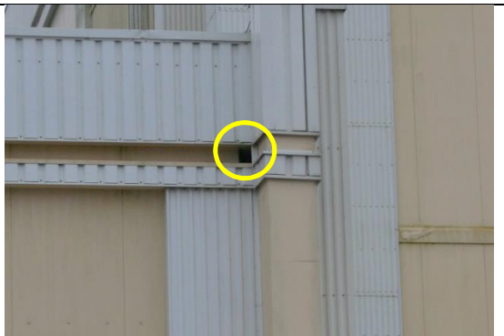
Foto 13: Offener Fassadenbereich im Übergangsbereich
