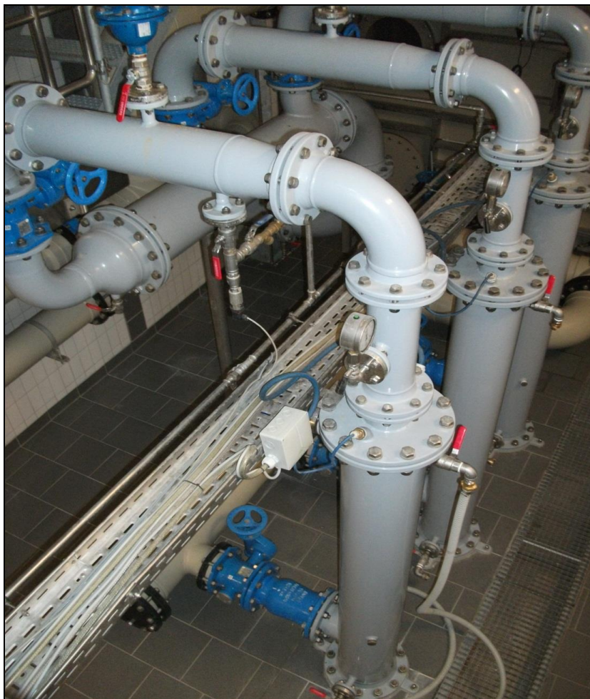
Abb.11: Neue Mantelrohrpumpen im Wasserwerk „Am Schaff“.
