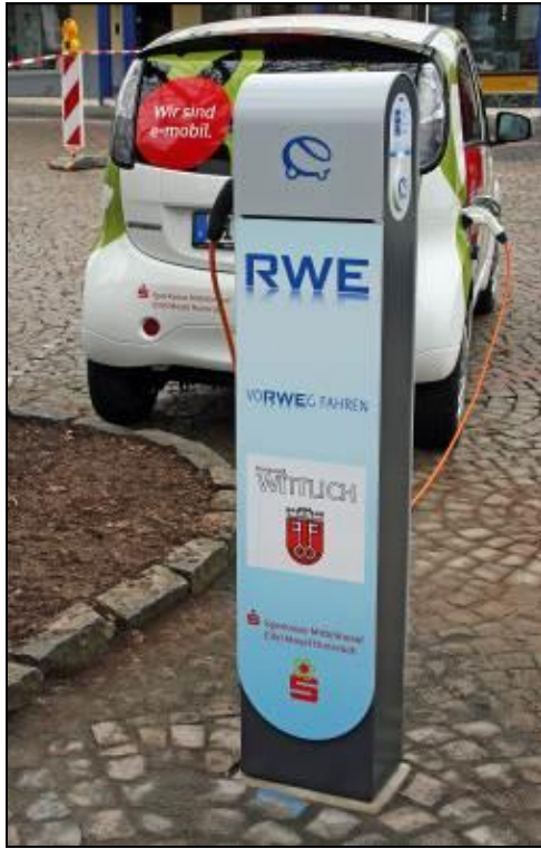
Abb. 2: Elektrotankstelle auf dem Schloßplatz
