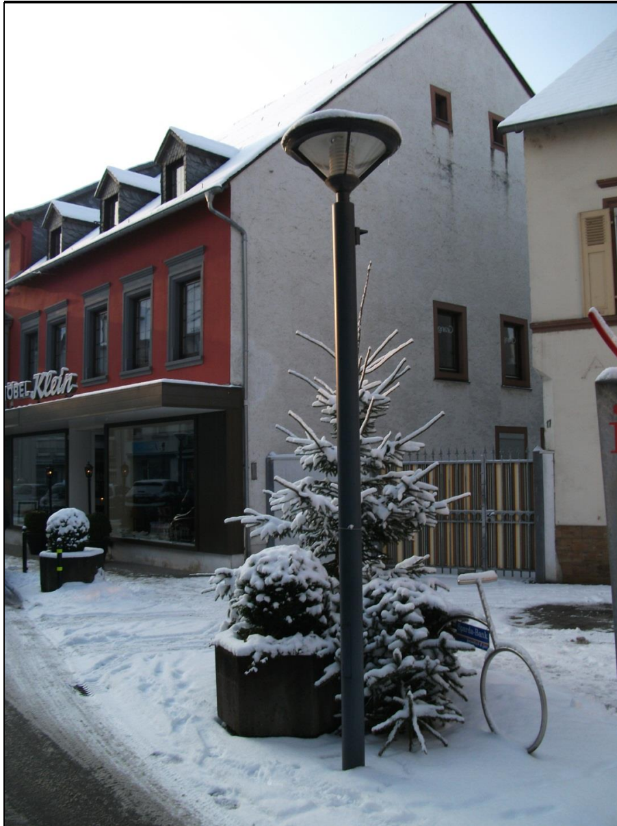
Abb. 12: Straßenlaterne mit LED-Technik in der Himmeroder Straße
