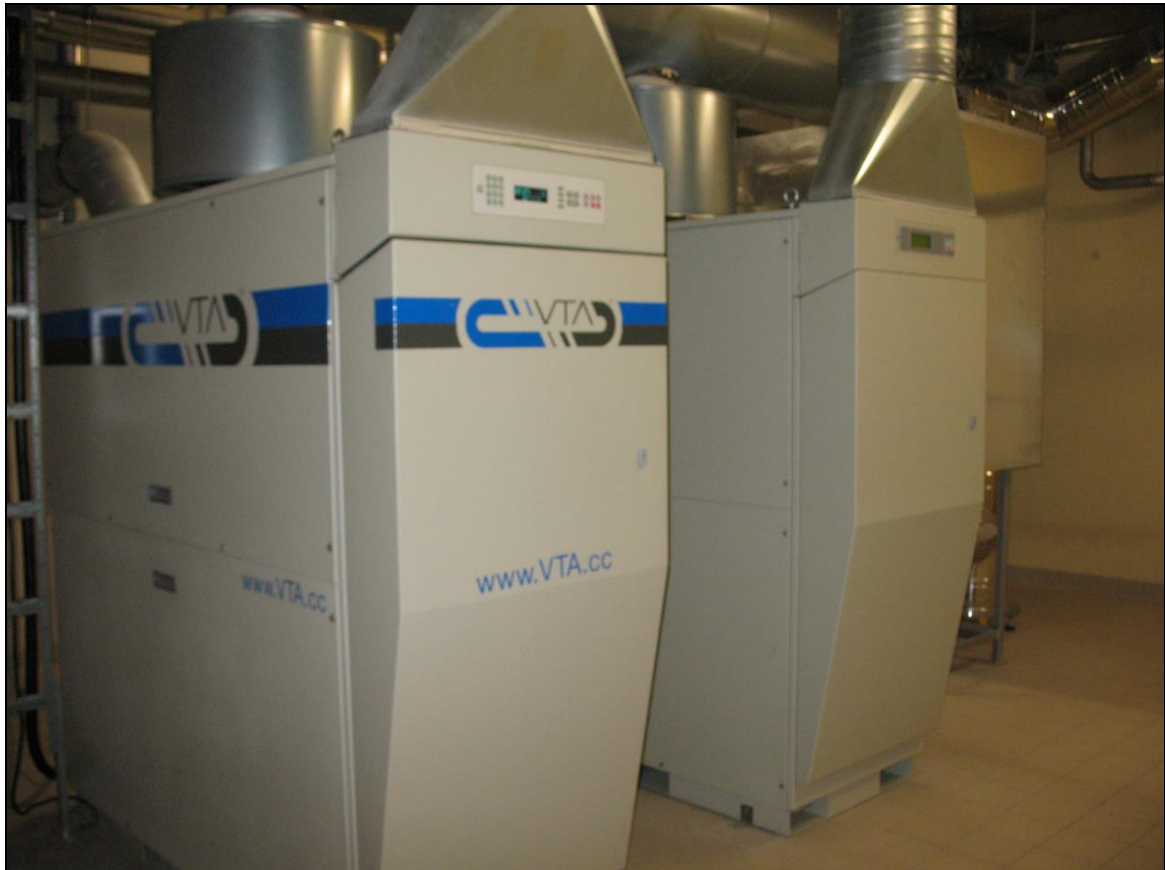
Abb.13: Neue Mikrogastrubine in der zentralen Kläranlage Wittlich
