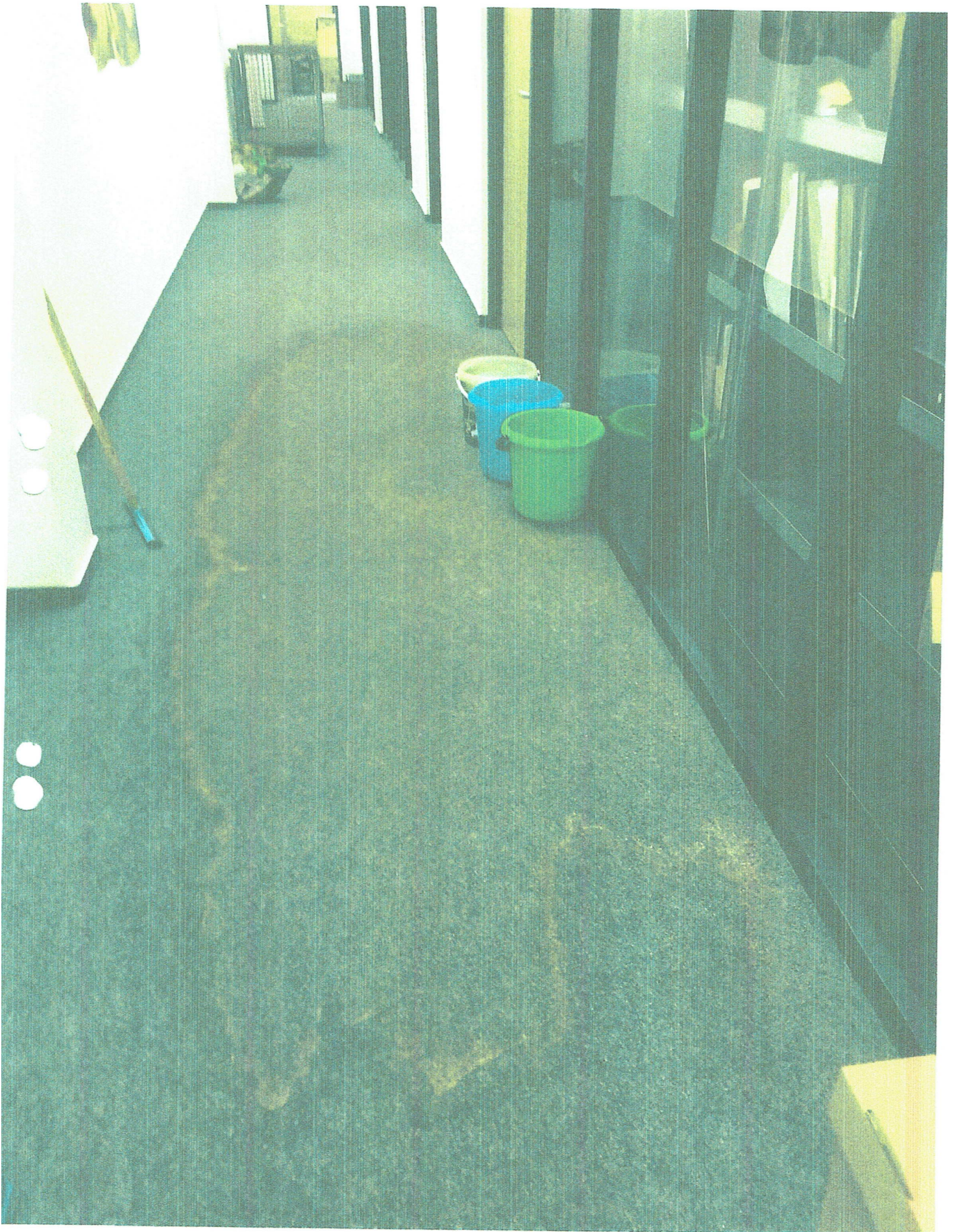
1st Zustand 1.06 Schäden unter Parquetboden
