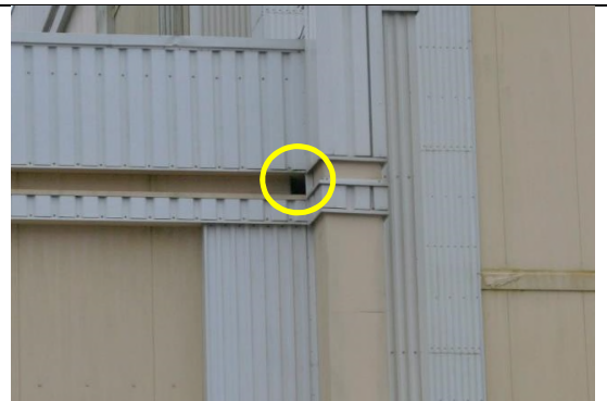
Foto 13: Offener Fassadenbereich im Übergangsbereich
